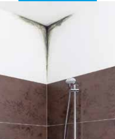
Superfici con evidenti problemi di muffa
